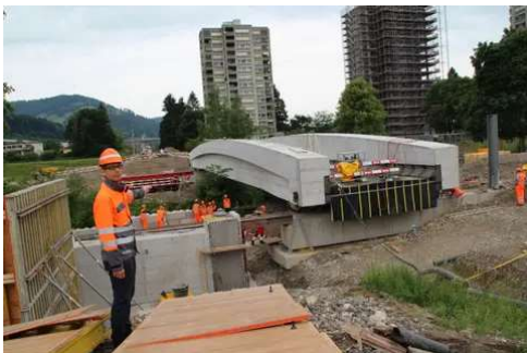
Manfred Guntlin zeigt die neue Thurbrücke der SOB in Ulisbach. Links im Vordergrund eines der Widerlager in der Gleisachse. (Bild: Martin Knoepfel)
